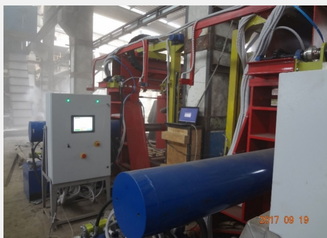
Rys. 3. Szafa sterownicza prasy filtracyjnej
